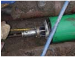
Z. B. Rohrverspannung beim Einzug.
